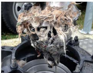
Verstopfte Pumpen, aufwändige Instandstellung.
